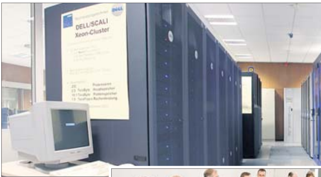
Labor der Zukunft: Hochleistungs-Rechenzentrum. Nolte
